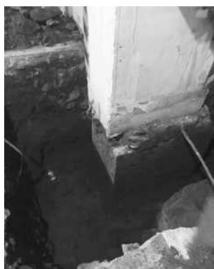
图 4.2.2-2 竖向构件错位实物图
